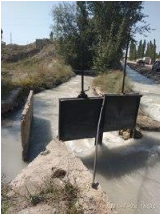
Image 7. Water outlet on PK144+39 (Отвод в с-л “Alga”)
